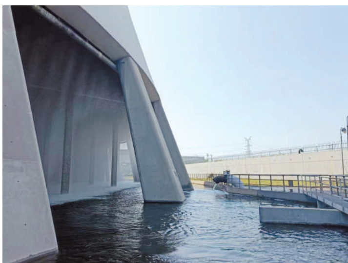
淮北中皖发电有限公司冷却水循环再利用。
