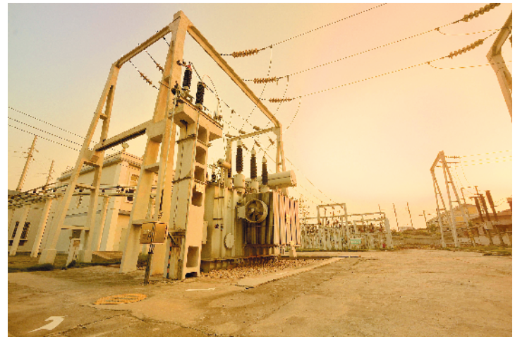
淮北地区首座变电站马庄变电站。
