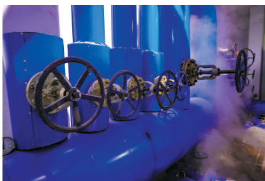
供热机房分汽缸。
