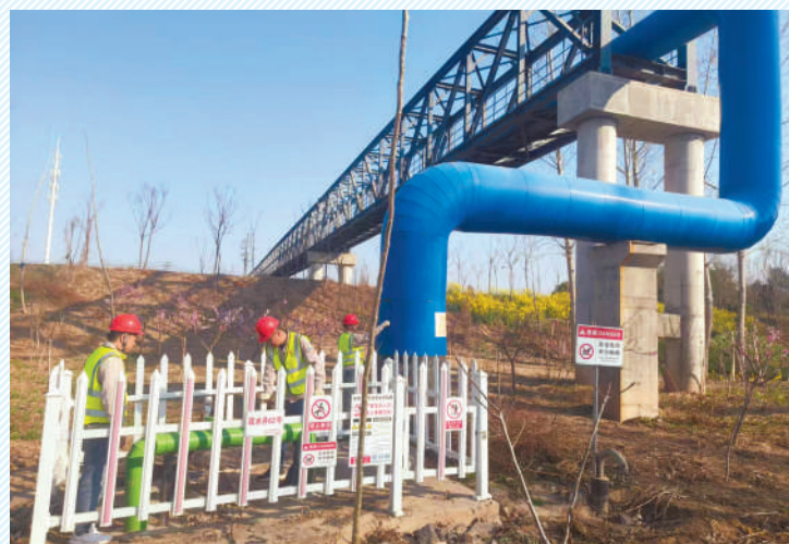
检查疏水井水位。
