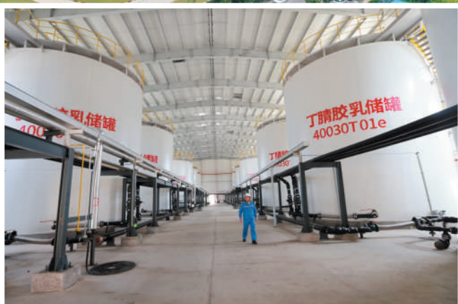
工人在安徽凯泽新材料车间巡查。
