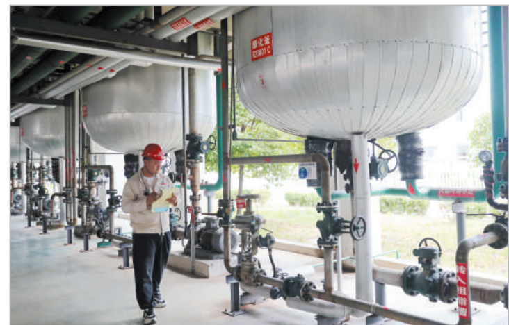
润岳科技工人在Tcsp车间反应釜进行日常巡检。
