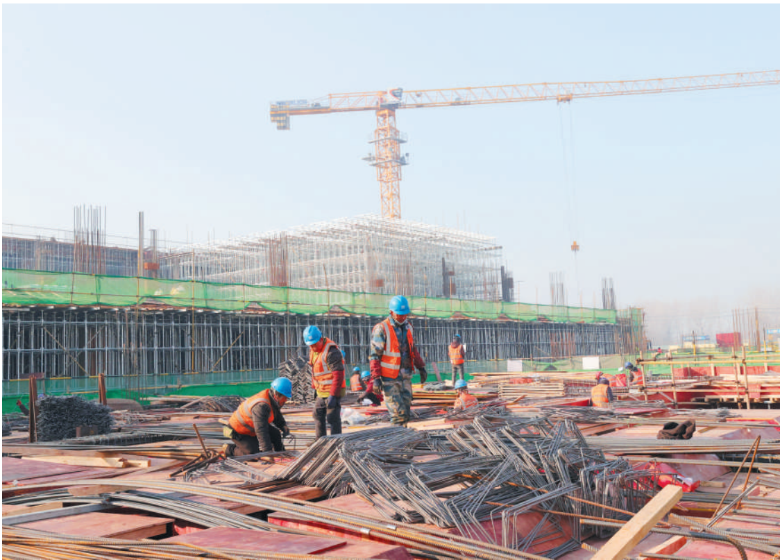
12月13日,工人在淮北翌光科技有限公司项目工地施工,力促项目早日投产。摄影 记者 冯树风
