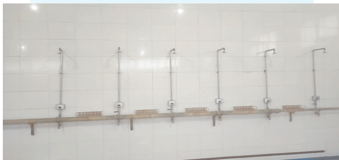
改造后的学生洗浴设施。
